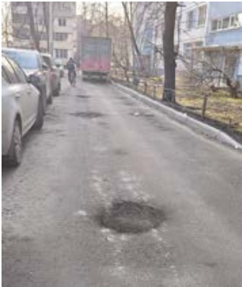
Устранение аварийности асфальта
